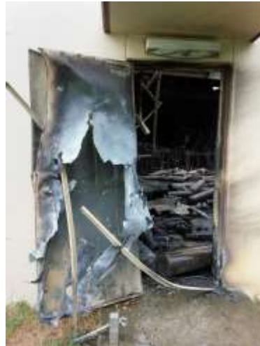
شکل شماره (۱) : انهدام درب بر اثر انفجار
