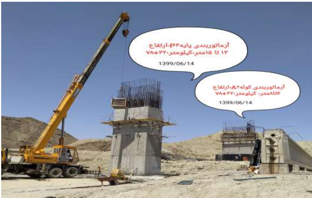
شکل شماره (۵): اجرای پایه‌های پل خاص کیلومتر ۳۲۰+۷۸ (۴*۳۰) از مسیر قطعه ۲ پروژه احداث راه آهن چابهار به زاهدان
