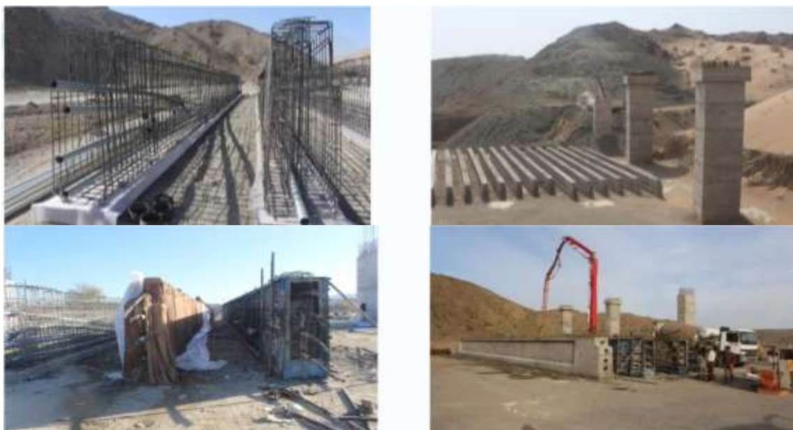
شکل شماره (۷): ساخت تیرهای پیش‌تنیده پل‌های خاص مسیر قطعه ۲ و ۴ پروژه احداث راه آهن چابهار به زاهدان
