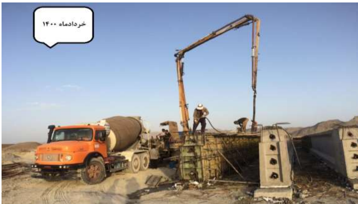
شکل شماره (۱): قالب بندی تیرهای پل خاص کیلومتر ۸۳۵+۱۰۶ (۳*۲۰) از مسیر قطعه ۲ پروژه احداث راه آهن چابهار به زاهدان
